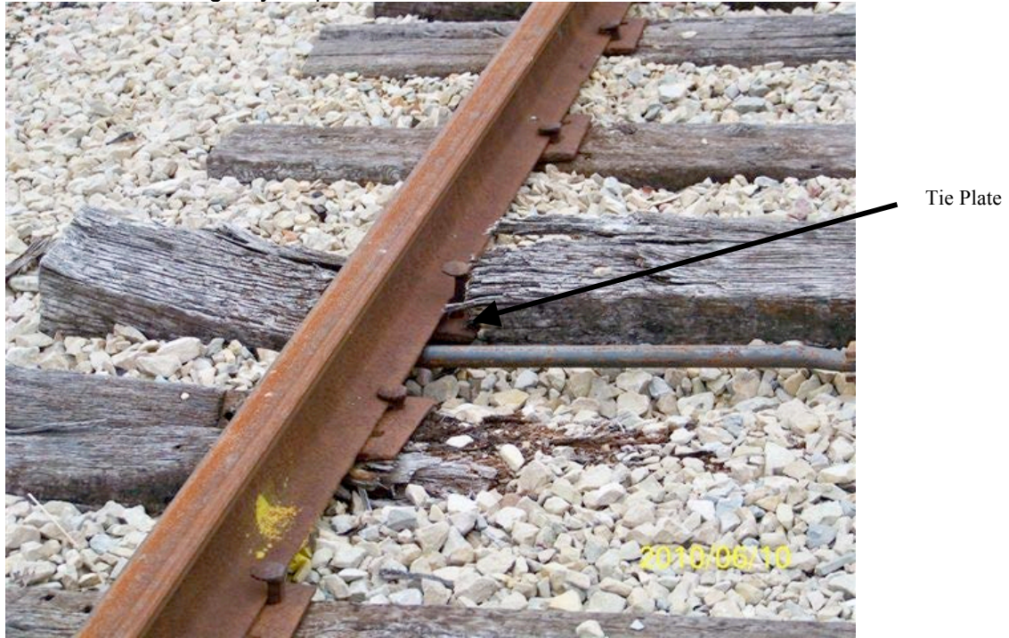
(Figure 18: Cut tie)
