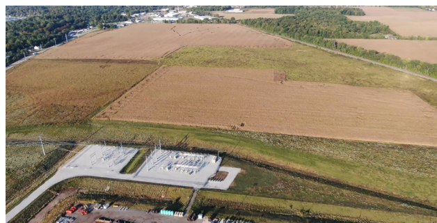
Vue aérienne en direction O.-S.-O. à partir de la route Decatur – Poste électrique en avant-plan, autoroute M-60 à gauche, voie ferrée du CN à droite
